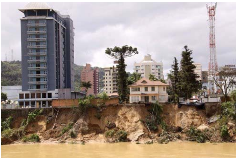
Figura 4 - Enchente de 2011 em Blumenau - Erosão na Margem Esquerda do Rio Itajaí-Açu
