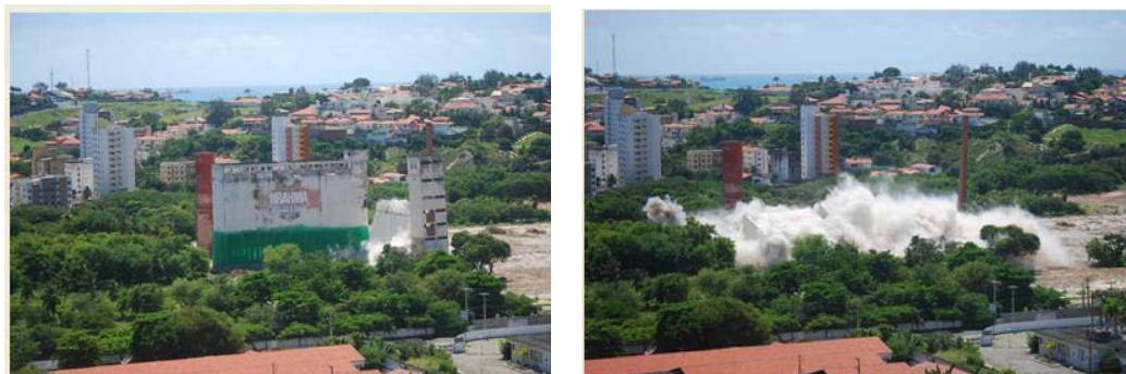
Imagens da antiga Fábrica Brahma e do momento da sua demolição. Fonte: www.fortalezanobre.com.br . IN: ALBUQUERQUE, 2015.
